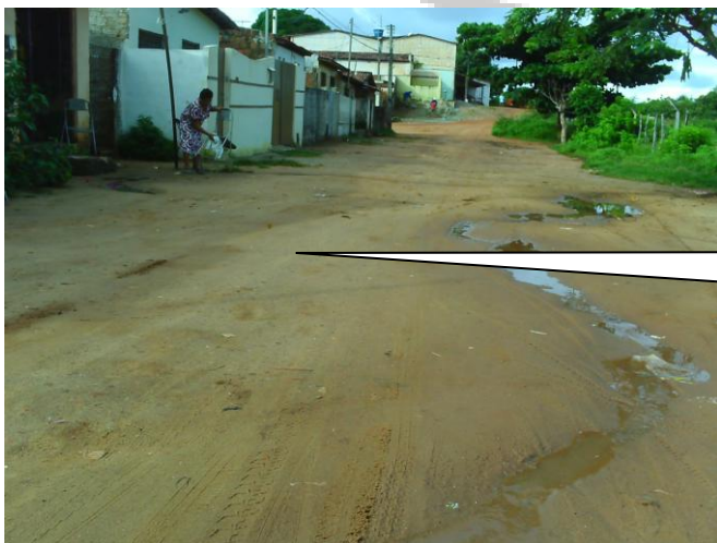
PONTO DE ALAGAMENTO NA RUA FRANCISCO DE ASSIS PRÓXIMO A RUA SANTO NOFRE
