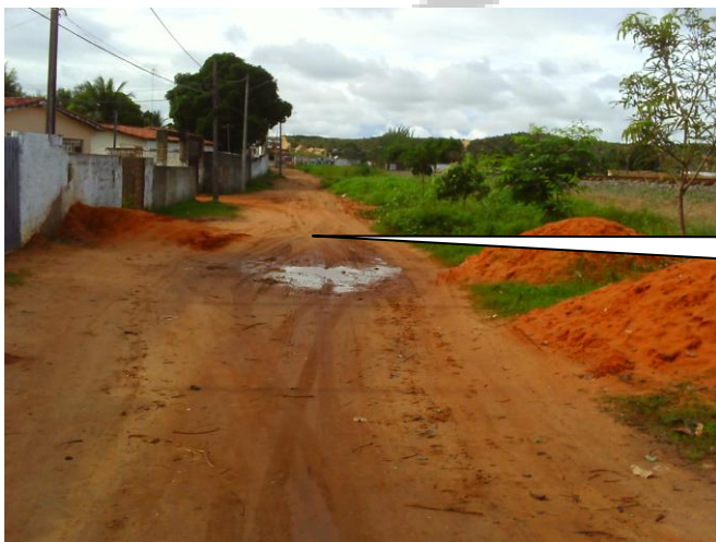
PONTO DE ALAGAMENTO NA RUA CARFANAUM
