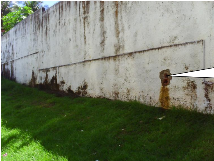
ABERTURA NO MURO DO SUPERMERCADO PARA ESCOAMENTO DAS ÁGUAS DAS CASAS GERANDO UM CONFLITO
