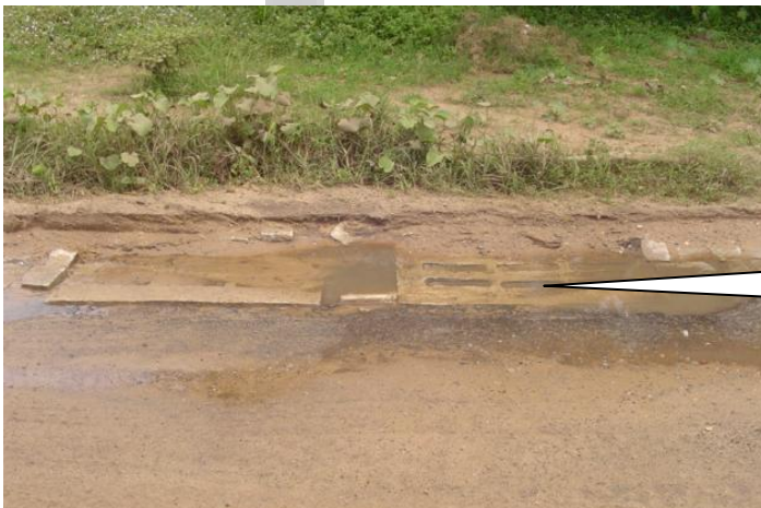
BOCAS DE LOBO OBSTRUÍDOS NA RUA AÇUDE SANTA RITA DE CÁSSIA
