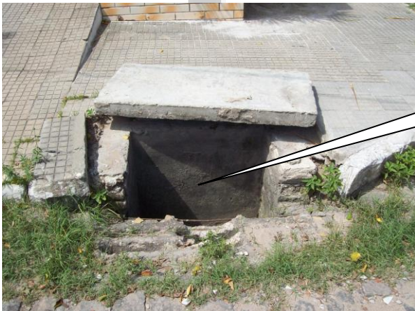
BOCA-DE-LOBO DANIFICADA A SER RECONSTRUÍDA
