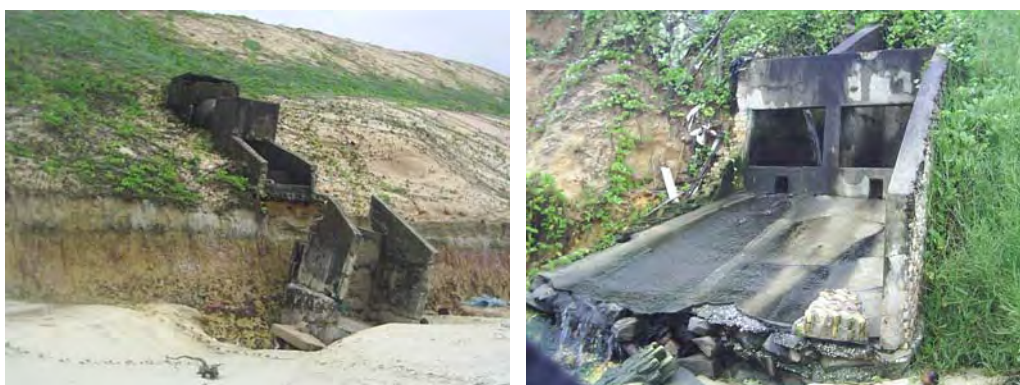
FIGURA 35. Tubulações por onde deságuam as águas pluviais provenientes do escoamento superficial. Comum encontrar pontos com águas misturadas de esgotos devido a ligações clandestinas
