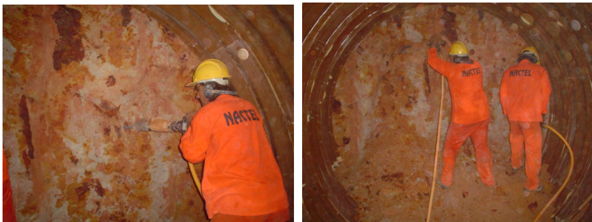
FIGURA 14. Camada laterítica encontrada na Zona Norte de Natal durante construção de um túnel a uma profundidade média de 20 m. A camada laterítica no local tem espessura aproximada de 3 m de largura
