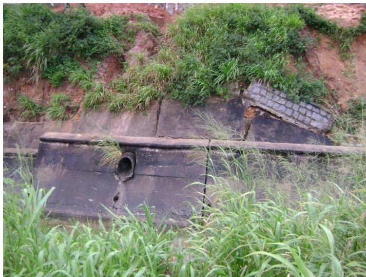
FIGURA 126. Processo erosivo junto às margens do Canal do Baldo.
