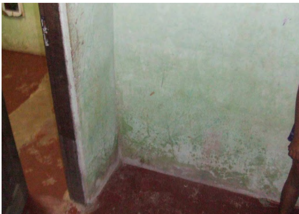
Figura 38 - Marcas do ultimo alagamento
