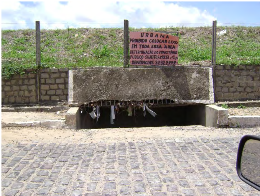
Figura 108 - Boca de lobo existente.
