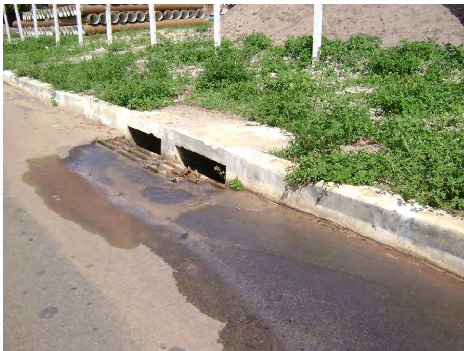
Figura 133 - Galeria de drenagem.
