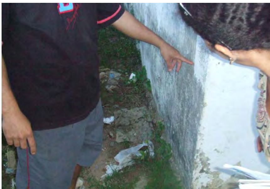
Figura 31 - Nível da água em dias de alagamento
