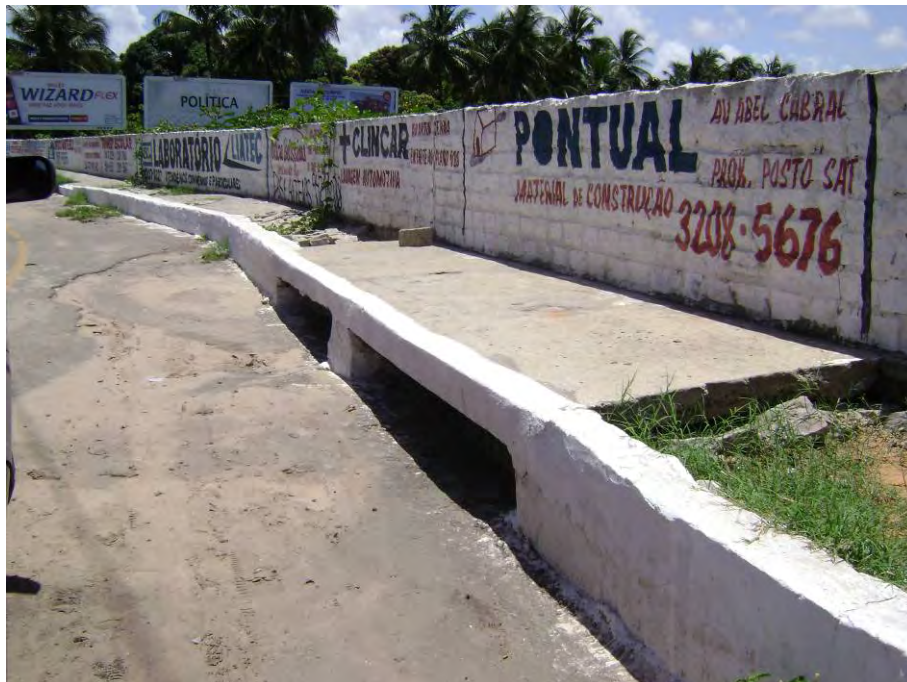
Figura 127 - Galeria de drenagem.
